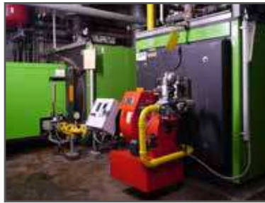
Кёльн, Германия Отопление комплекса зданий и подогрев воды.
