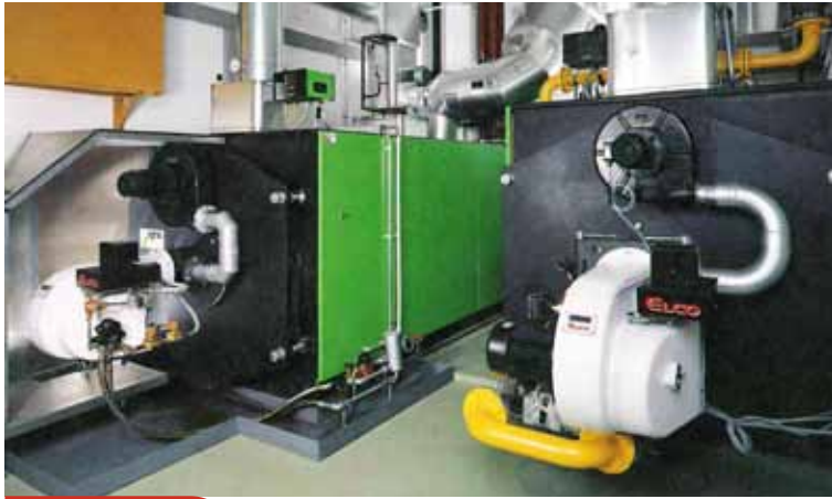
Bruciatori ELCO dotati di sistema FGR installati in Svizzera per soddisfare gli standard richiesti dallo "Swiss Clean Air Act" (1992)
