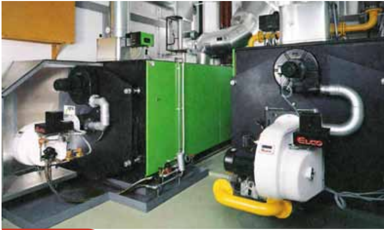
Bruciatori ELCO dotati di sistema FGR installati in Svizzera per soddisfare gli standard richiesti dallo "Swiss Clean Air Act" (1992)
